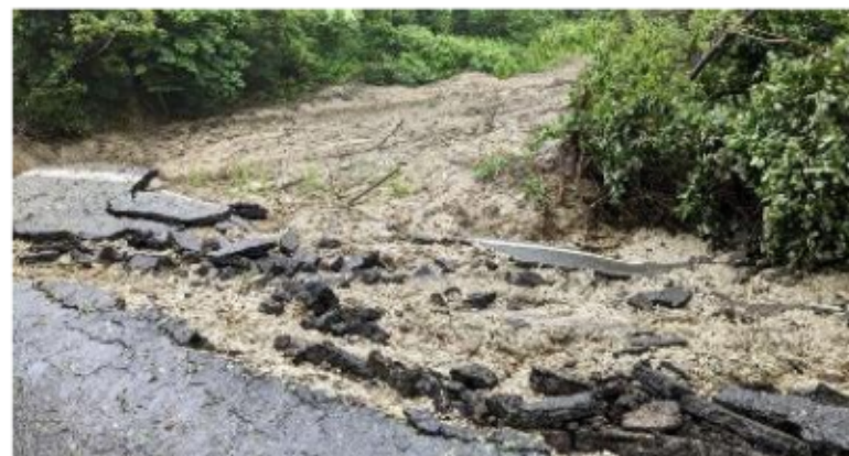
Una strada consortile danneggiata da una frana
